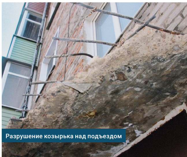
Разрушение балкона вследствие попеременного замораживания и оттаивания
